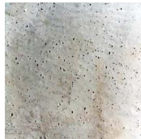
Vzduchové póry v podkladu
