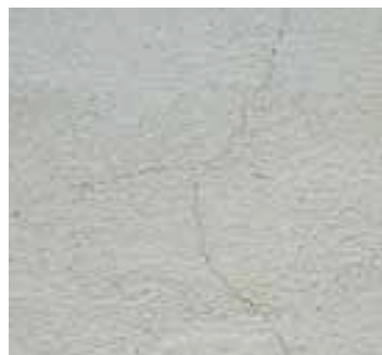
Nepravidelně popraskaná omítka
