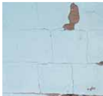
Trhlinky opisující spáry ve zdivu
