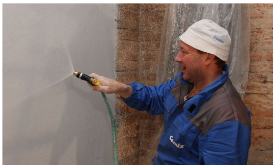
♥ Zvlhčení povrchu omítky
