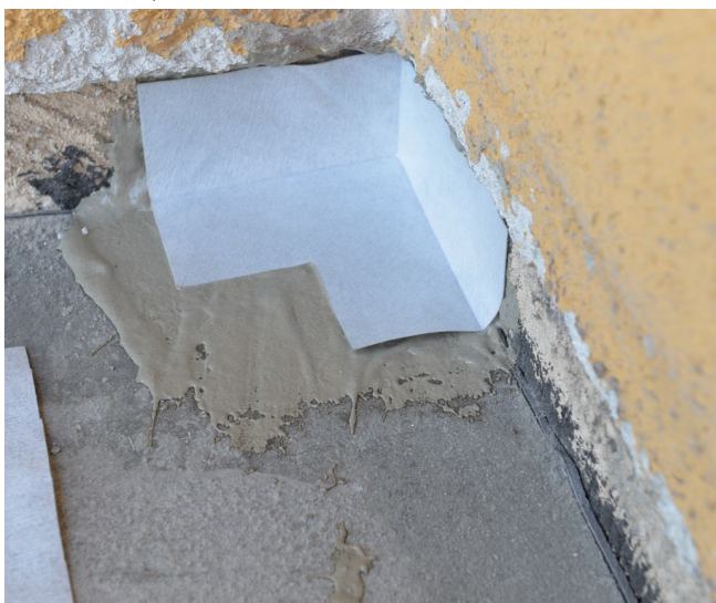
Pružná těsnicí páska uložena do první vrstvy hydroizolace před nanesením druhé vrstvy.
